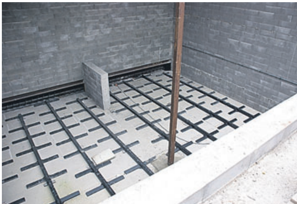
Hakkeen liikkumisesta varaston lattialla huolehtii kahdeksan tankopurkainta. Ruuvi siirtää haketta sivuttain reunoilta keskelle vasemmalta lukien toisen tangon kohdalle, josta hake putoaa pystykuljettimen kouruun.
