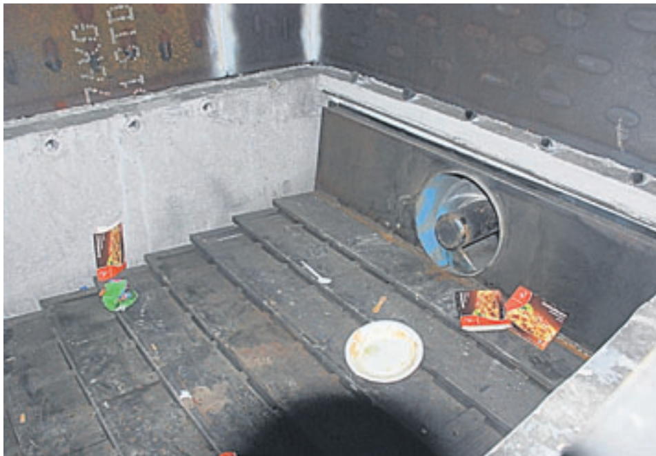
Haketta kattilaan tuo yksi ruuvi. Virit ovat jo pesässä lähinnä antamassa mittakaavaa. – Loiva porrasarina on havaittu toimivaksi ratkaisuksi, kertoo Veli-Matti.
