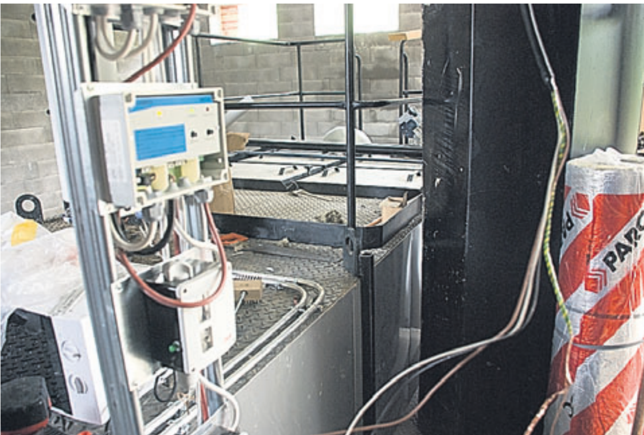
Kun tällä laitoksella päädyttiin märkään tuhkaan, se ratkaisi monta ongelmaa. Kattila voidaan huoletta nuohota painevedellä taustalla näkyvistä luukuista. Kun nuohous on nopea ja miellyttävä tehdä, silloin se tulee tehtyä. – Laitoksella on tarkoitus päästä 85 % vuosihyötysuhteeseen ja se onnistuu kun savukaasujen lämpötila saadaan pidettyä lähellä 160 astetta, kertoo Veli-Matti.
